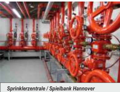
Sprinklerzentrale / Spielbank Hannover
