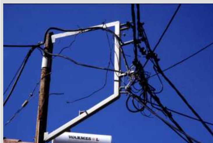
DIN-gerechte Verkabelung ? (Korfu)
