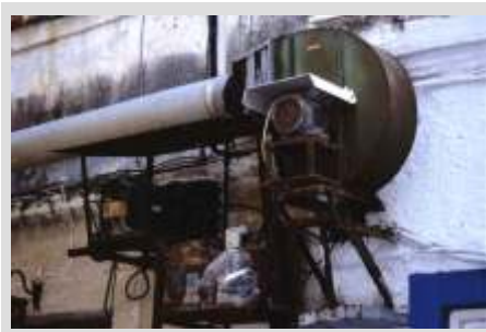
Abluftanlage / Kälteerzeugung (Korfu)
